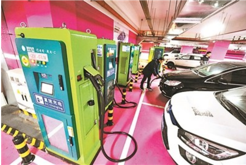
天桥演艺中心停车场安装了百余充电桩
